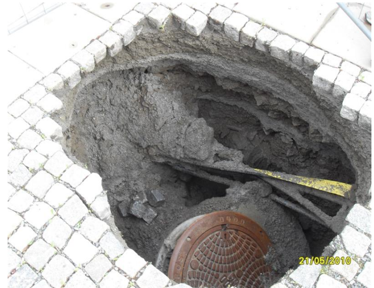
Setningsskade i leire som følge av inkompetent dimensjonering
